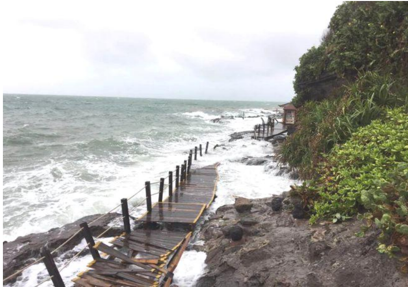
图3 “森拉克”台风风暴潮期间涠洲岛滨海木栈道受损情况
