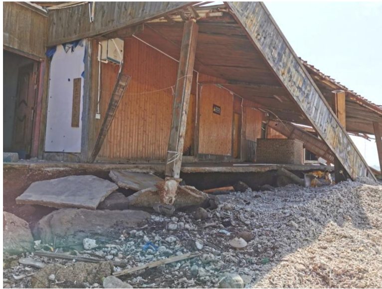
图 5 涠洲岛石螺口至滴水村岸段南部房屋地基受侵蚀
