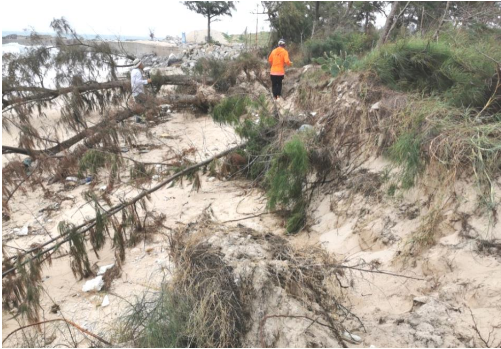
图 7 涇洲岛后背塘至横岭岸段防风林侵蚀倒伏
