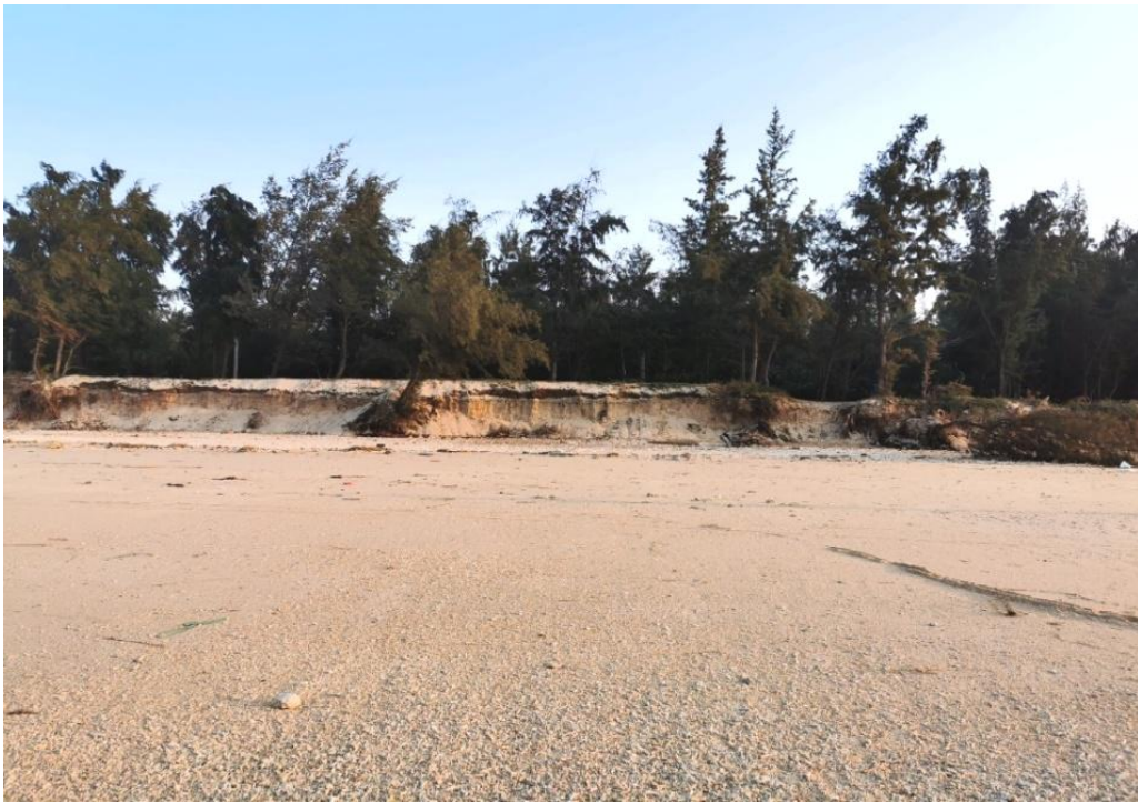
图 8 涇洲岛后背塘至横岭岸段岸呈现侵蚀陡坎
